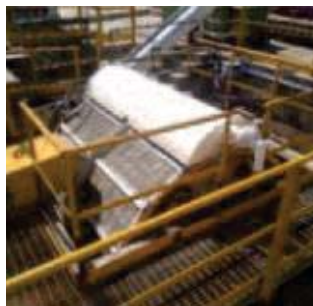
廢水處理系統設置過濾單元
