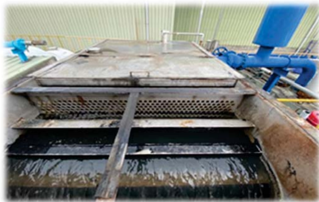
廢水處理前端槽內設有過孔阻隔
