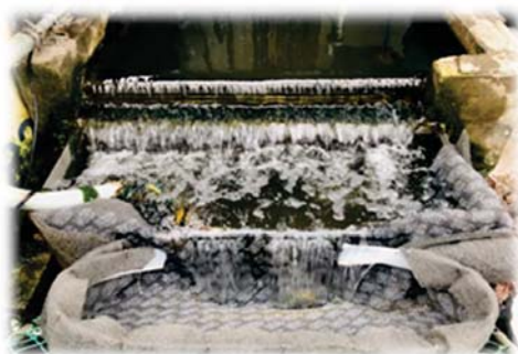
放流口設有過濾棉
