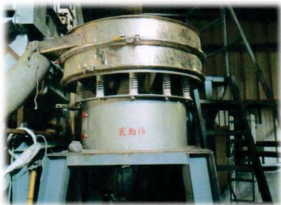
廢水處理設施前端設有震動篩
